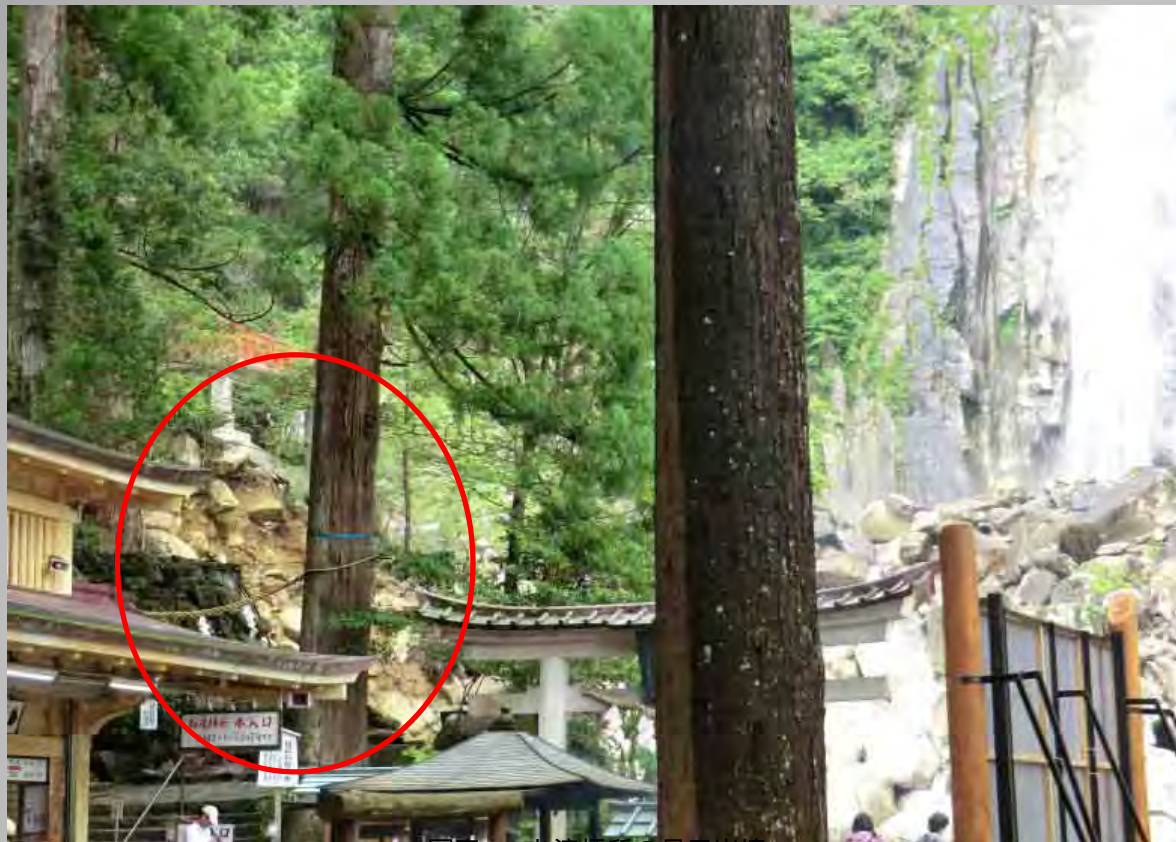
写真15 お滝拝所の足元崩壊
